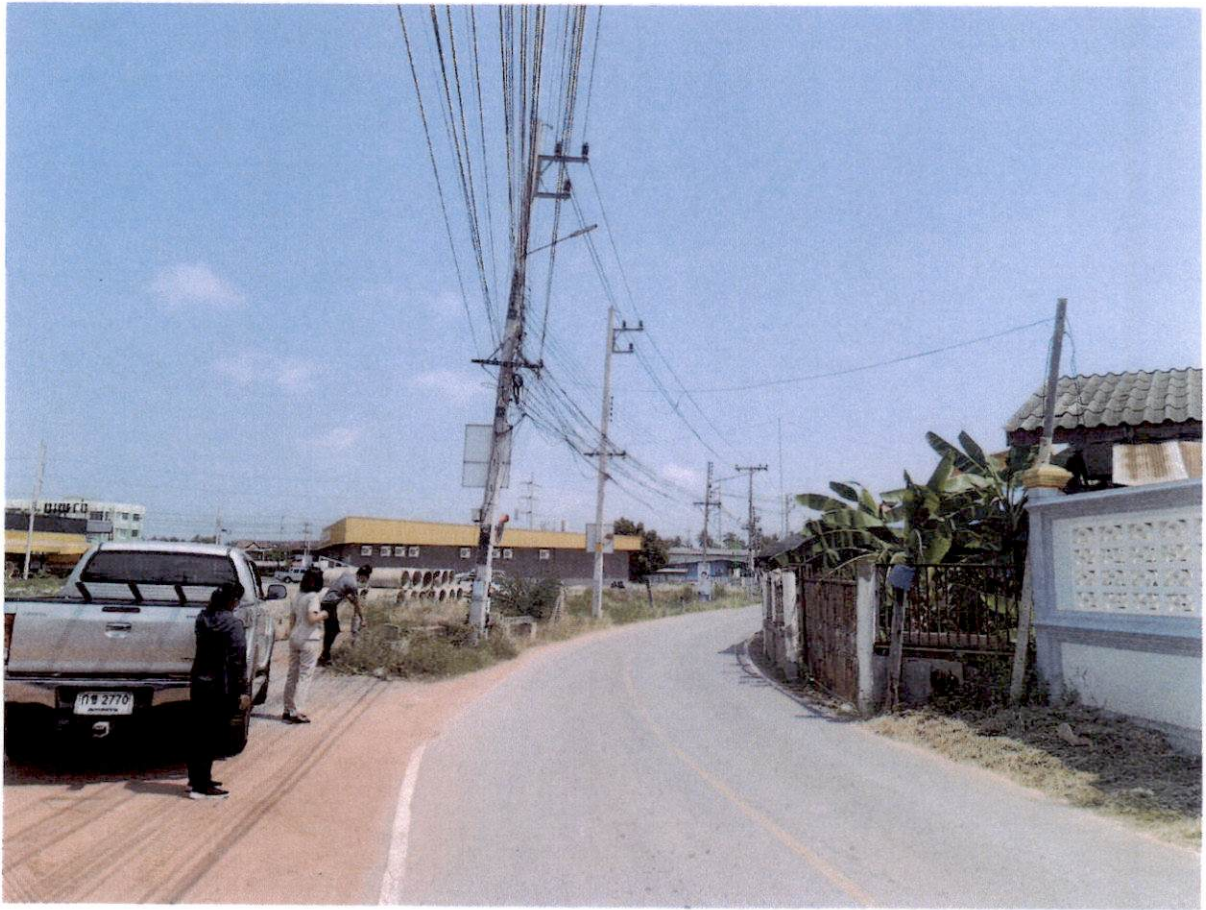
ชาวบ้านขอให้ช่วยย้ายเสาไฟฟ้า (เสาไฟฟ้าเอน) บริเวณซอยซัซวาล์ หมู่ที่ ๖ ตำบลบ้านปรก อำเภอเมืองสมุทรสงคราม จังหวัดสมุทรสงคราม
